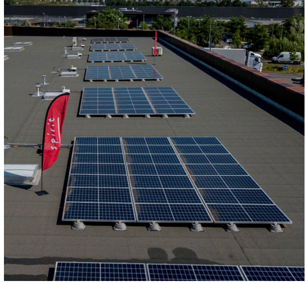
Panneaux photovoltaïques sur le toit du Spirit Business Cluster Tremblay-en-France (93) - AeroliansParis - Grand Paris Aménagement Anne Carcelen Architecture et Land'Act
