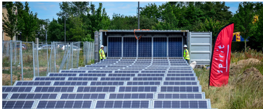
Spirit déploie le Solar GEM® pour alimenter en énergie photovoltaïque son chantier du Parc Spirit du Mantois, situé au cœur du quartier Mantes Innovaparc à Bacheluy (78)
